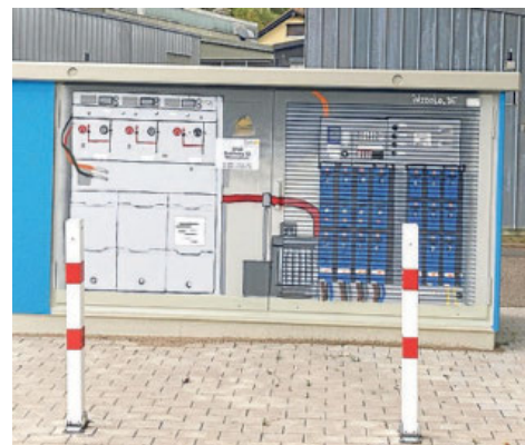
Auf dem Aldi-Parkplatz kann man das Innere der Trafo-Station begutachten. Foto: privat
